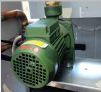
Pompa di circolazione - Circulating pump
